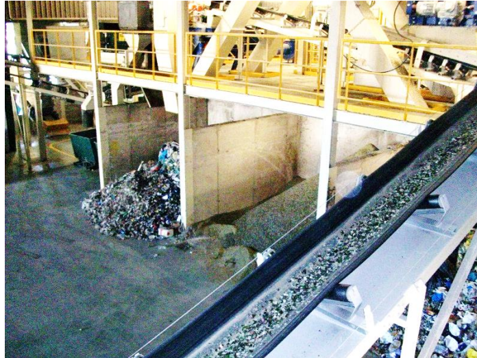
Figura 11: Planta de tratamiento BA Vidrio Distribución y Comercialización de Envases, SA,
