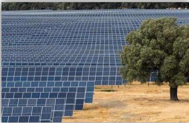
Figura 2: Producción de energía solar fotovoltaica.
